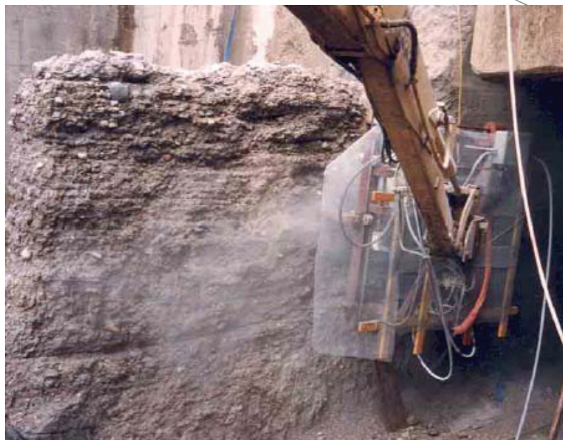
Σχήμα 2: Αποδιοργάνωση σκυροδέματος με υδροκοπή (hydrodemolition) σε κάθετη επιφάνεια (Χρήση εξοπλισμού με ρομποβραχίονα)
